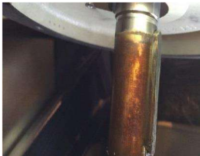
Рис 6: Участки коррозии на валу двигателя
